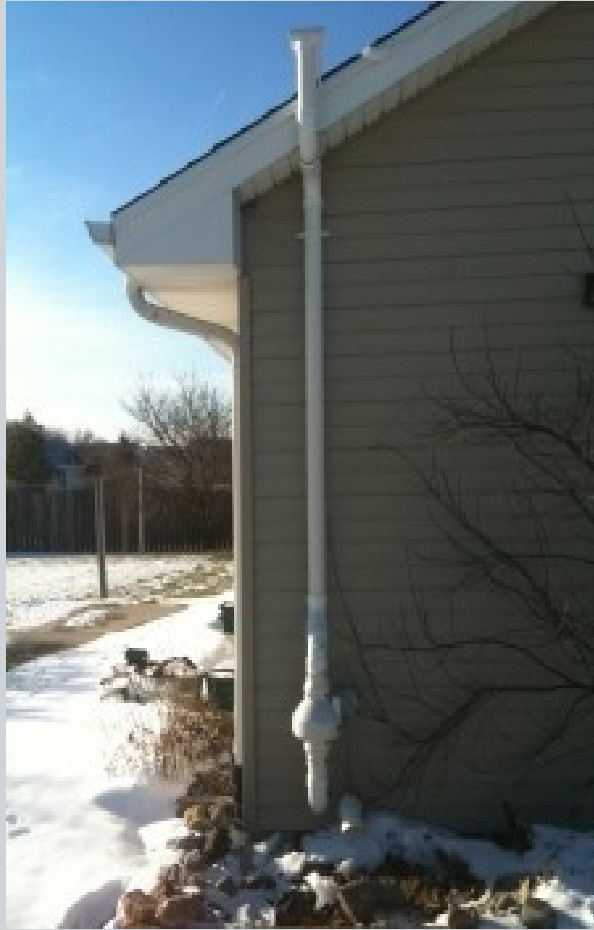
Proper exterior riser pipe
